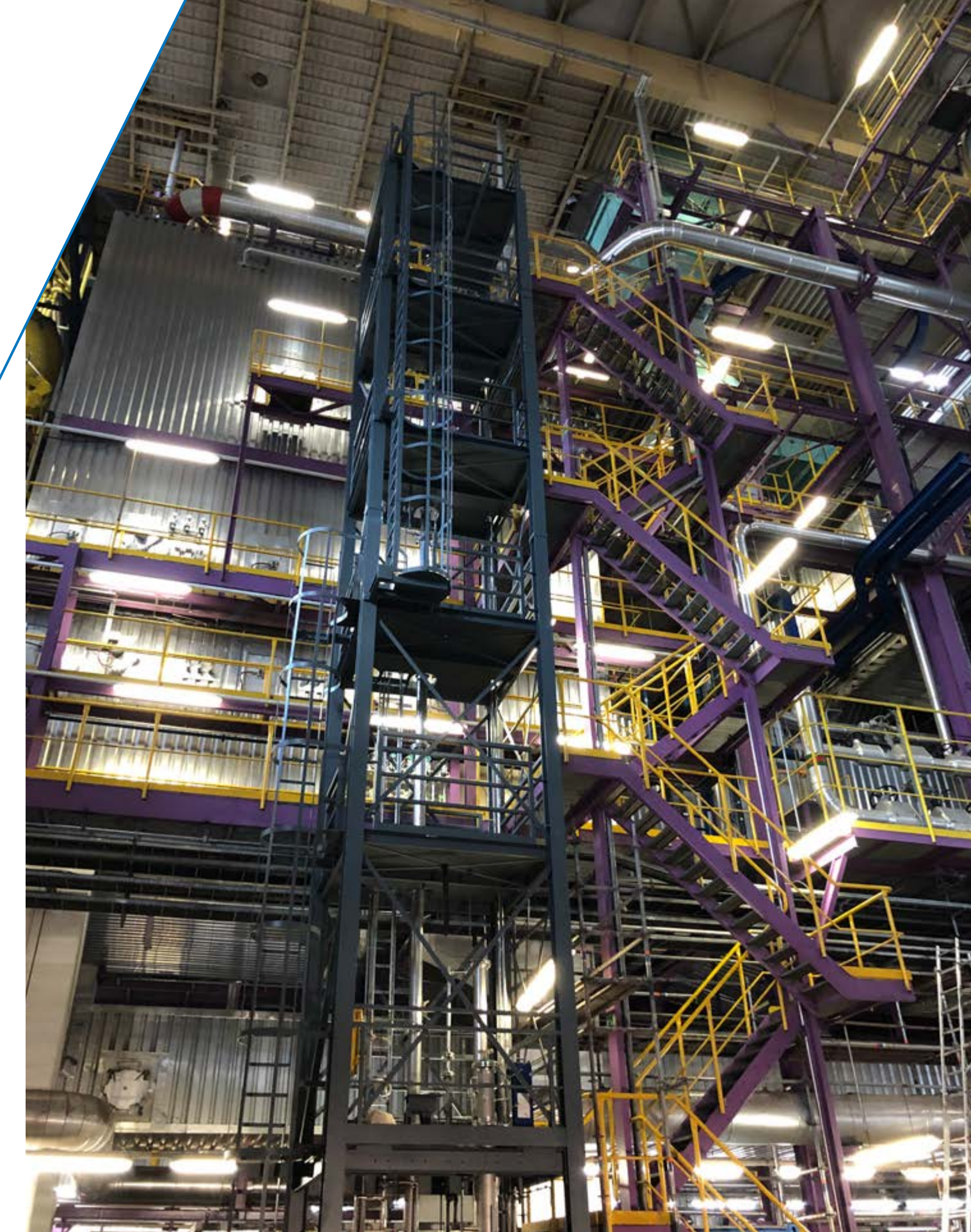
ANDRITZ hat 2023 seine erste CO 2 -Abscheideanlage an die Stahlindustrie geliefert. Die Pilotanlage wurde im zweiten Quartal im Stahlwerk der voestalpine in Linz, Österreich, in Betrieb genommen. Die Anlage scheidet mithilfe eines von ANDRITZ konzipierten Amin-Verfahrens aus den Rauchgasen der Eisenerzeugung Kohlendioxid ab.
